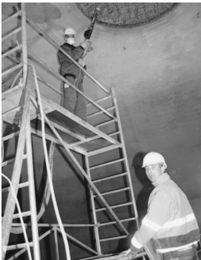
Job in luftiger Höhe: Andreas Hahn (l.) und sein Kollege Heiko Rieche von der Firma W+S Bau-Instandsetzung entfernen mit einem Hochdruckstrahler die marode Wassertank-Innenbeschichtung.
